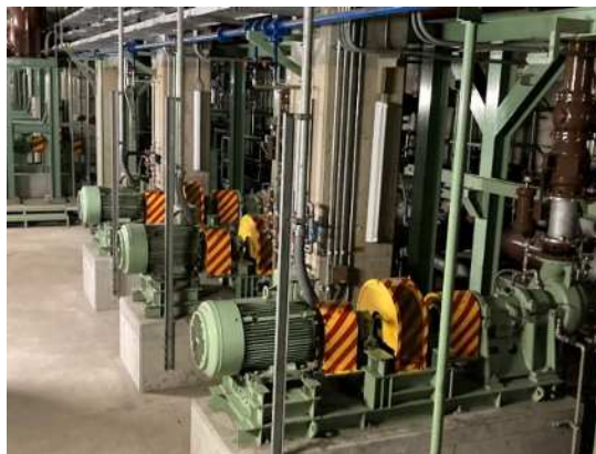
森ヶ崎水再生センターのポンプ設備（施工例）
